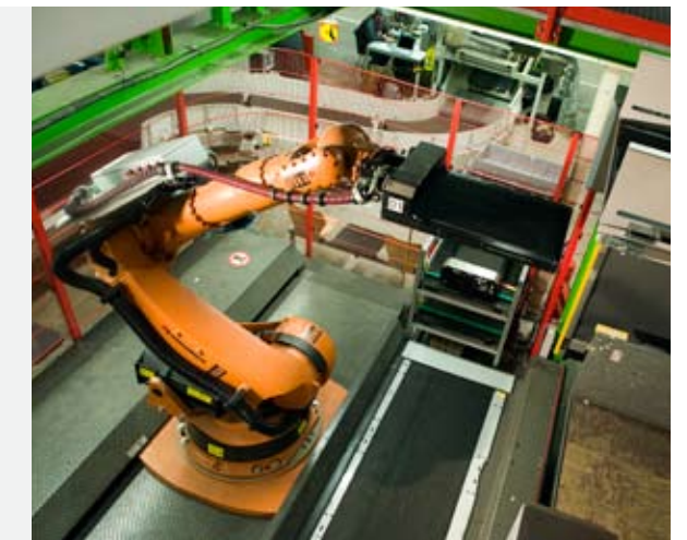
Nieuwe robotcel in gebruik genomen in bagagekelder op Schiphol
